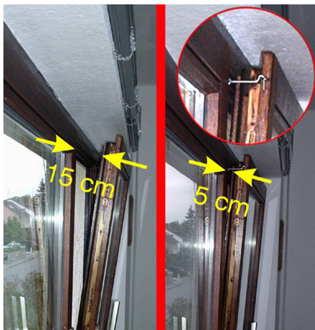
Eine einfache Möglichkeit das unbeheizte Schlafzimmer an kalten und windigen Tagen energiesparend zu belüften ist das Anbringen eines „Sturmhakens“ an einem Kippfenster. (Links die normale Kippstellung und rechts mit eingehängtem Haken)
